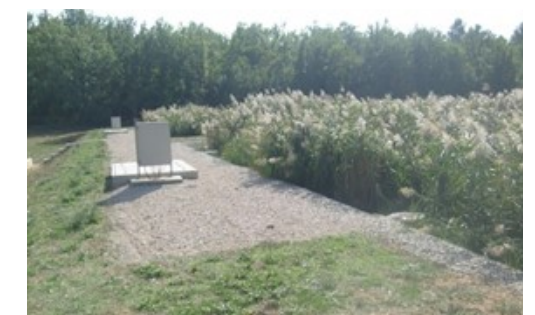
Figure 88 : Station d'épuration plantée de Rougiers (© http://www.epurnature.fr/fr/nos-realizations/rougier )
